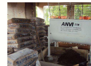
FIGURA 32 – CENTRAL DE DOSAGEM DE ARGAMASSA
