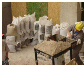
Figura 9 – Central de dosagem de areia
