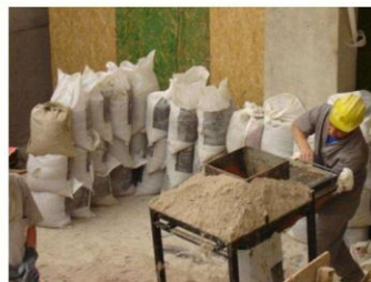
Figura 9 – Central de dosagem de areia
